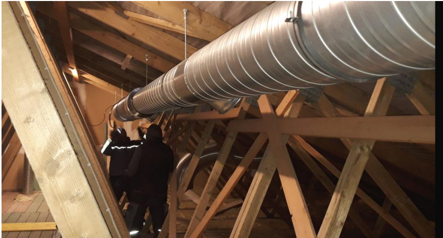
(Bild 4 Lüftungsanlage auf dem Dachstuhl)
